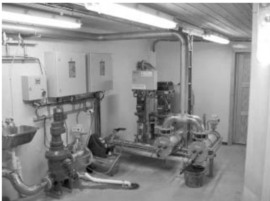
Renseanlegget ved Tonnes Vannverk (foto: U/N-etaten)
